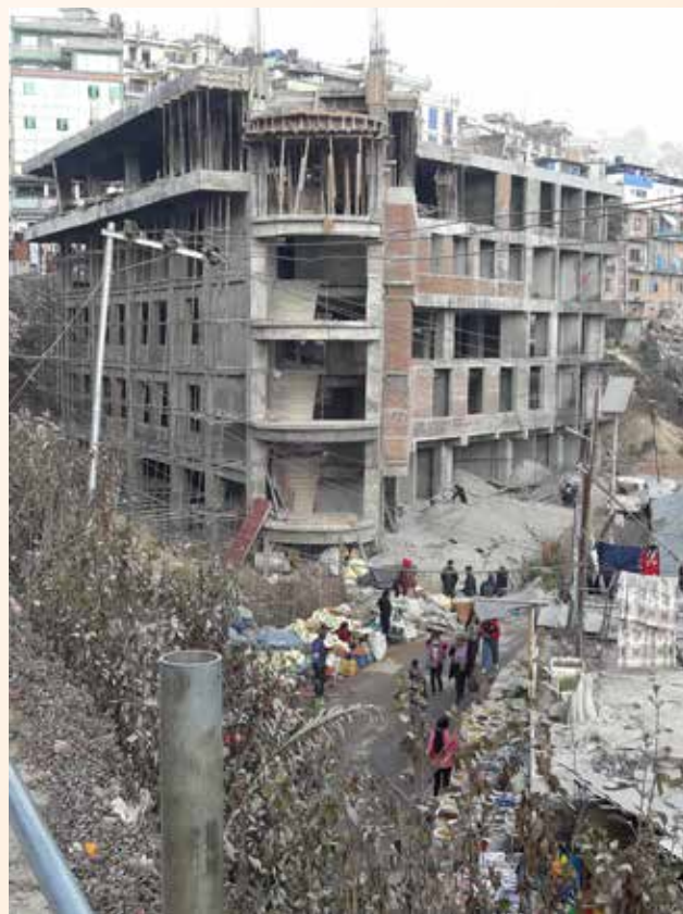
(फोटो नं. १ : नगर विकास कार्यक्रम तेस्रो चरण अन्तर्गत निर्माणाधीन भिमेश्वरको व्यावसायिक भवन)
