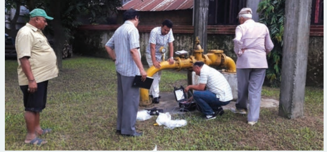
फोटो नं. १४ : विर्तामोड साना शहरी खानेपानी तथा सरसफाई आयोजना अन्तर्गत संचालनमा रहेको खानेपानी पम्पिङ्ग केन्द्रको विज्ञ टोलीबाट उर्जा दक्षता मापन गरिदै ।
