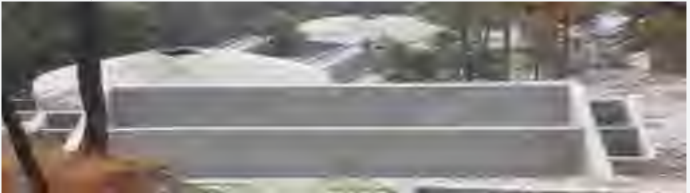
फोटो नं. ८ : मझौला शहर एकीकृत शहरी वातावरण सुधार आयोजना (STIUEIP) अर्न्तगत काभ्रेभ्याली एकीकृत खानेपानी आयोजनाको नव निर्मित जल भण्डारण केन्द्र लगायत अन्य संरचनाहरू
