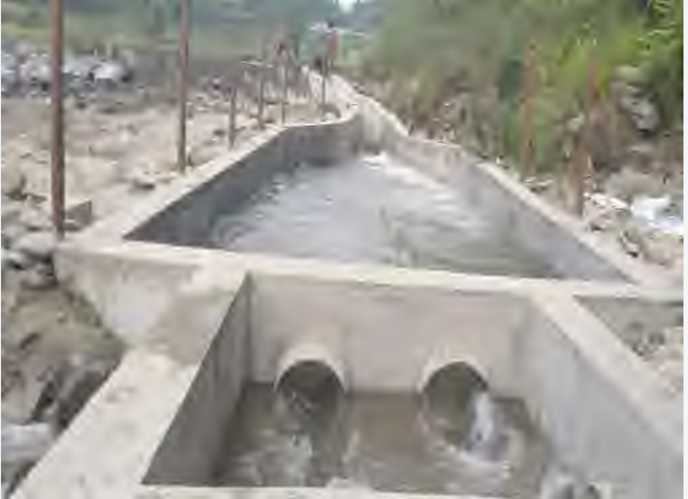
फोटो नं. ५: विदुर साना शहरी खानेपानी तथा सरसफाई आयोजना अन्तर्गत निर्मित खानेपानी आयोजनाको इन्टेक संरचना
