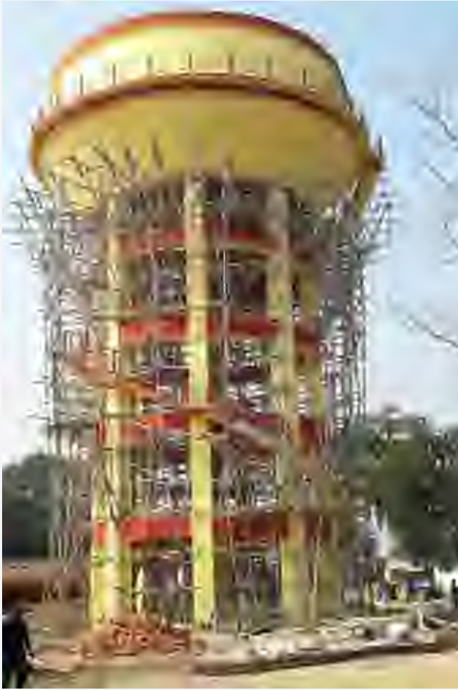
फोटो नं. ४: तेस्रो साना शहरी खानेपानी आपूर्ति तथा सरसफाई आयोजना अन्तर्गत निर्माणको अन्तिम चरणमा रहेको लालबन्दी खानेपानी तथा सरसफाई आयोजनाको ओभरहेड ट्याङ्की
