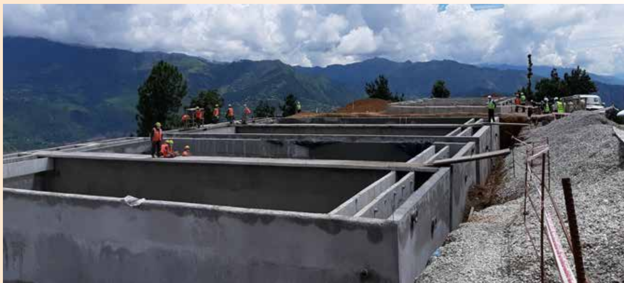
(फोटो नं. ६ : शहरी खानेपानी तथा सरसफाई आयोजना अन्तर्गत पाँचखाल खानेपानी आयोजनाको निर्माणाधीन भौतिक संरचना)
